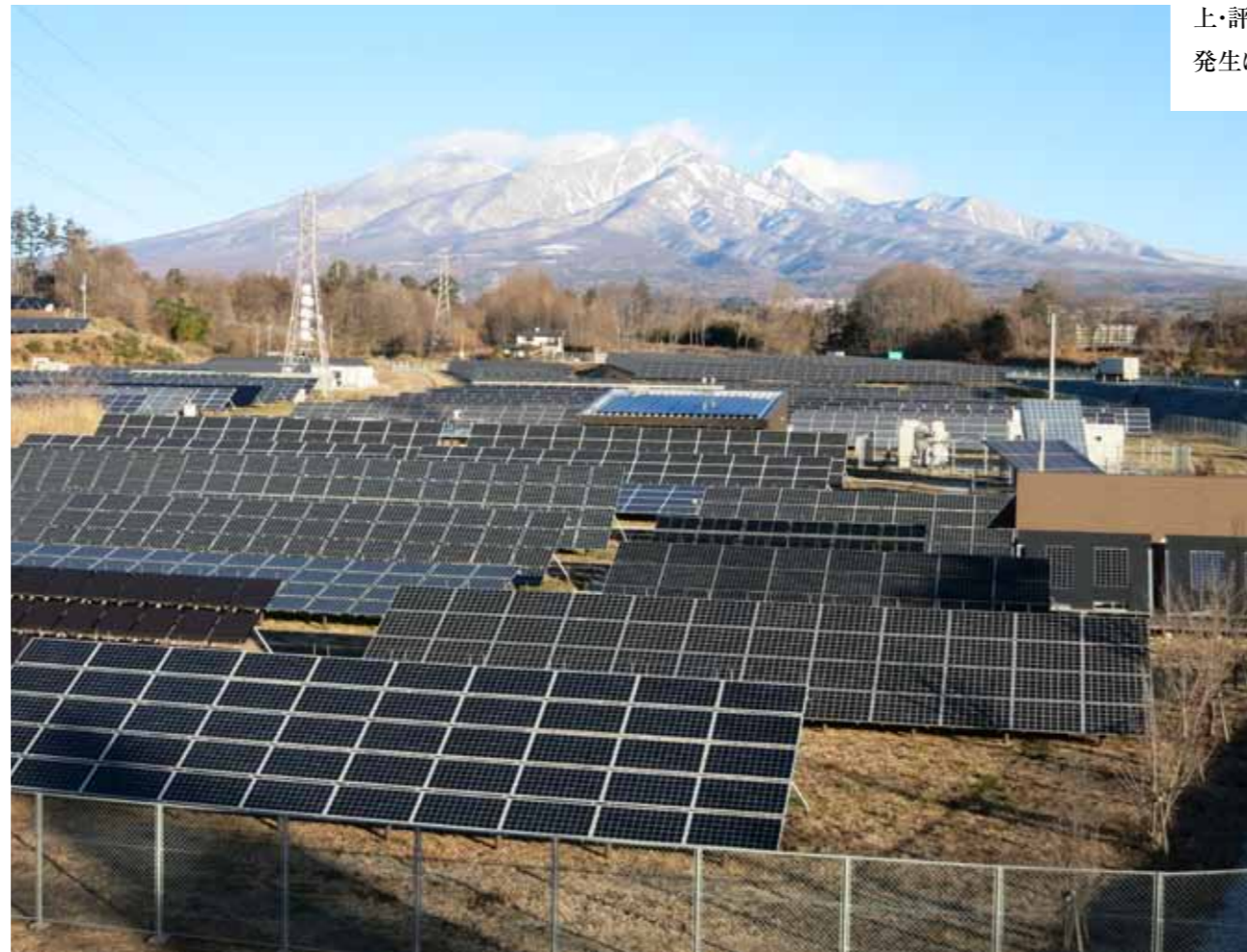
北杜サイト太陽光発電所 (2006年度～2010年度大規模電力供給用 太陽光発電システム安定化等実証研究)
