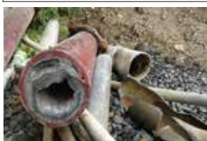
鳴子温泉スケール付着状況
