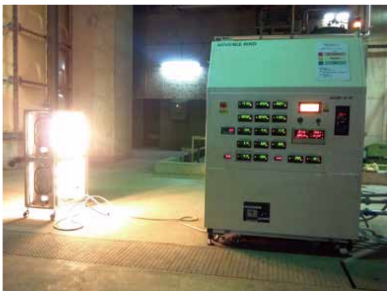
浮島処理センターにおける 実証実験 ECOR-3 運転中
