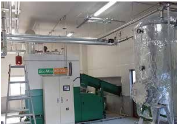
木質バイオマスボイラー（200Kw）
