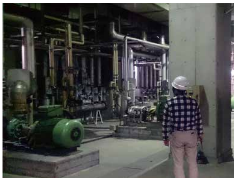
プラント内既存配管より、温水・冷水を ECOR-3 へ提供
